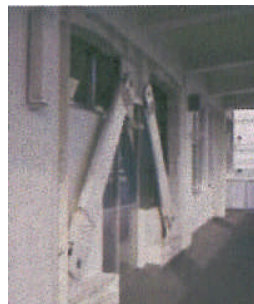
廊下側壁への設置例
