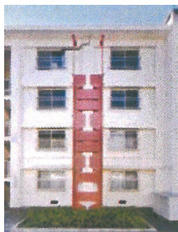
[補強工事時] パネル形式の粘弾性 ダンパー
